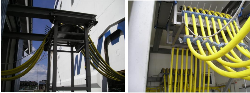
Figuren ovan visar en landanslutning med 690 V, 9 x 250 A. Pilotstift, reläer och brytare med underspänningsmagnet förhindrar ofrivillig spänningssättning från båda håll.
